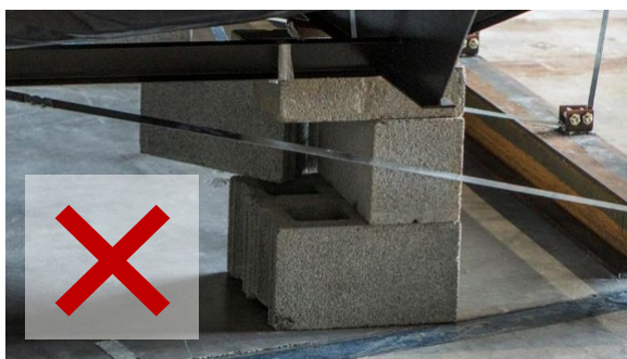
Figura 2.3: Cimientos apilados en seco no elegibles
