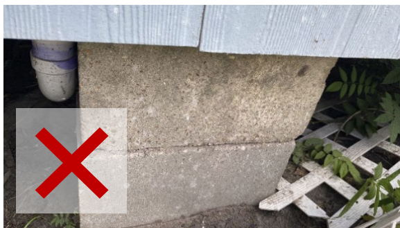
Figura 2.1: Cimientos apilados en seco no elegibles
