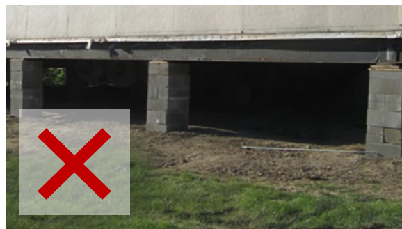
Figura 2.2: Cimientos apilados en seco no elegibles
