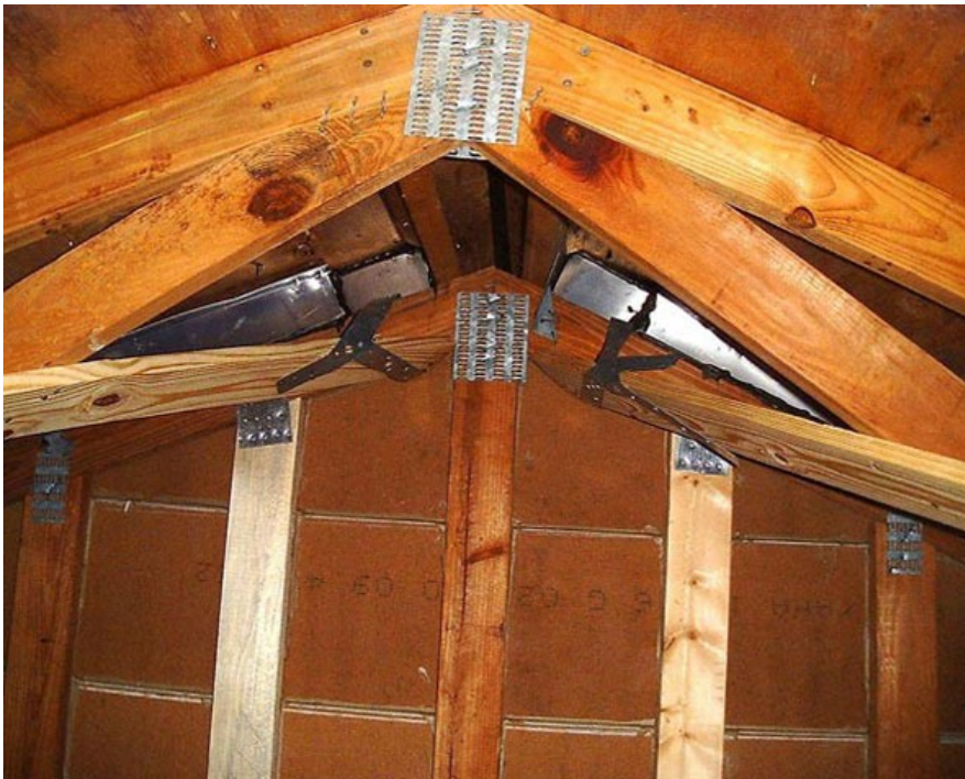
Figura 5.3. Bloqueo de los respiraderos de los sofitos del reborde de los hastiales con tapajuntas metálico
